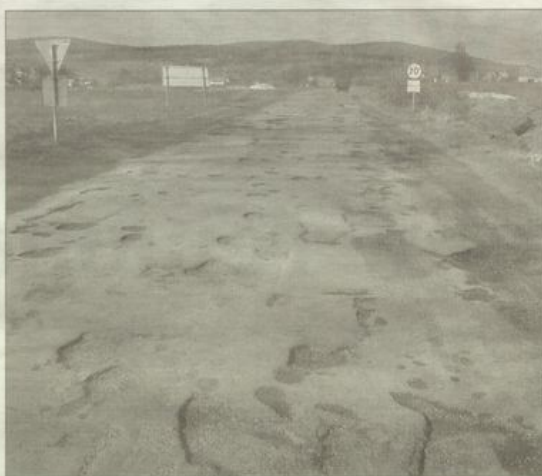
Zwiększenie natężenia ruchu pojazdów działa destrukcyjnie na już zniszczoną nawierzchnię drogową.
